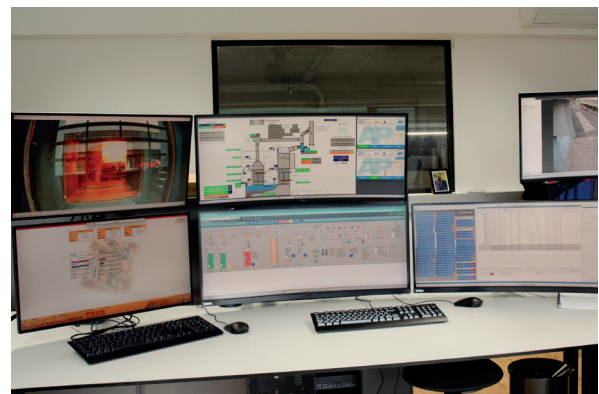
Alles im Blick: Die Schaltzentrale der Nahwärme Weidach. Im Endausbau 2028 werden 38 Mio. kWh nachhaltige Wärme erzeugt (Fotos: © Energieinstitut Vorarlberg).
