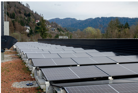
Erneuerbare Energie wird auf dem Dach mit einer 175 kWp-PV-Anlage mit Ost-West-Ausrichtung erzeugt.
